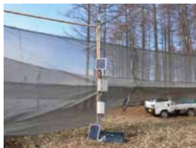
ソーラー電源による稼働
