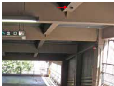
屋内駐車場の監視
