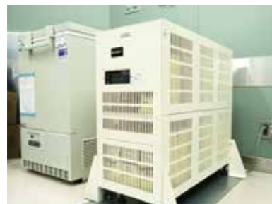
屋内設置型の大容量無停電電源装置
